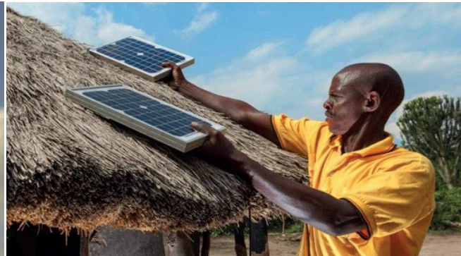
Installation d'un kit solaire photovoltaïque domestique constitué d'un panneau solaire relié à une batterie et à un contrôleur de charge
